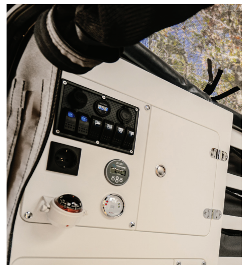
Panneau de commande électrique
